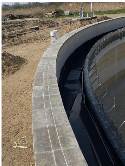
Ogrzewane płyty bieżni osadnika radialnego – PWiK Legnica; oczyszczalnia Legnica; średnica 50m
