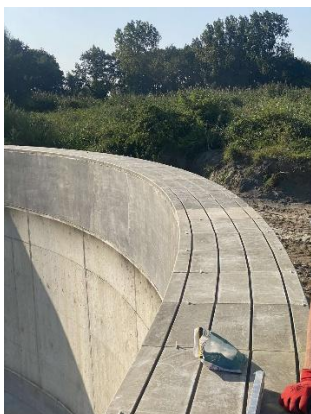
Ogrzewane płyty bieżni osadnika radialnego – PGKiM Ozimek; oczyszczalnia Antoniów; średnica 25m
